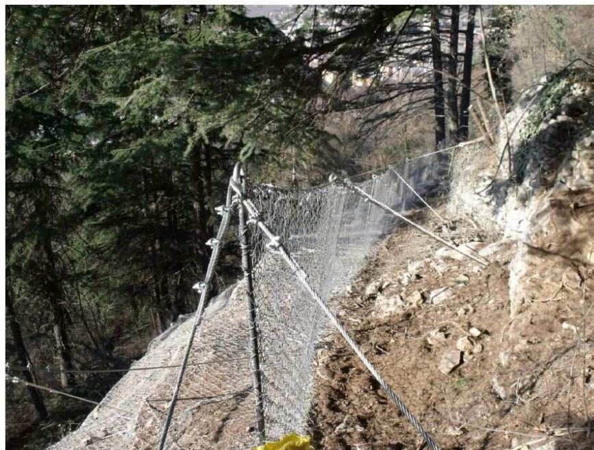
Foto 3.3.5: una barriera sommitale ad una parete rocciosa rivestita con maccaferri. Risvoltando quest'ultima come in foto e dotandola di adeguati sostegni ed ancoraggi, si riesce a realizzare una economica barriera in grado di intercettare e trattenere blocchi di non elevate dimensioni in rotolamento sul versante a monte.
